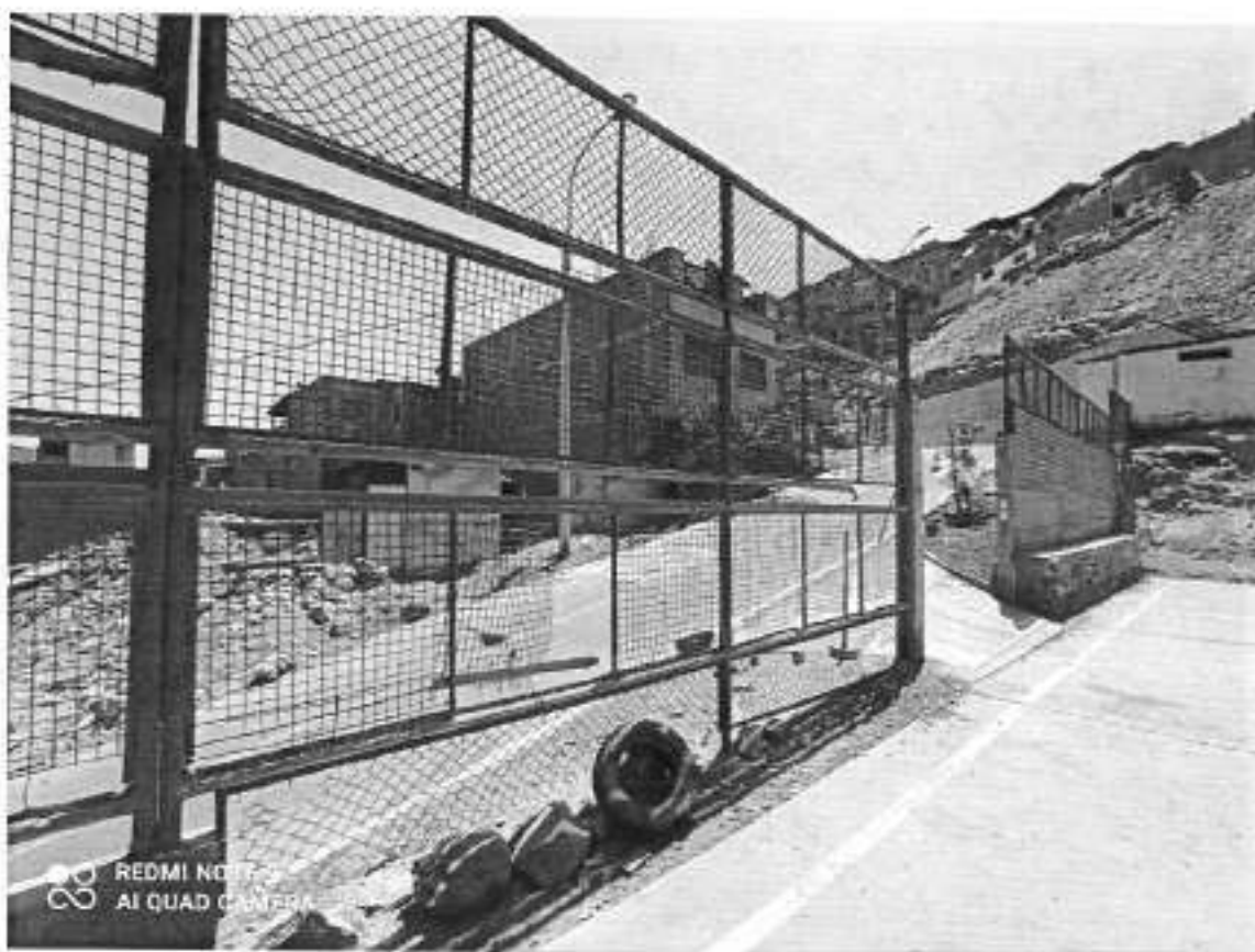
Mallas en mal estado (oxidadas). Espacio deportivo sin entrada. Permite el ingreso de personas extrañas procedentes de Pamplona Alta.
