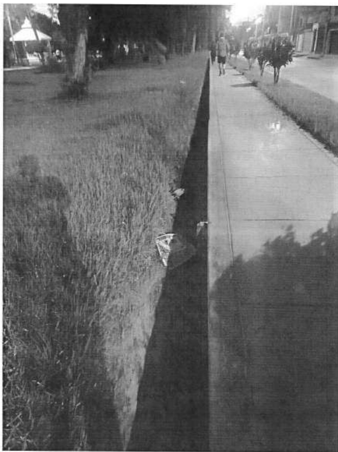
ZONA PELIGROSA BERMA DEL PARQUE CALLE DOÑA LUISA
