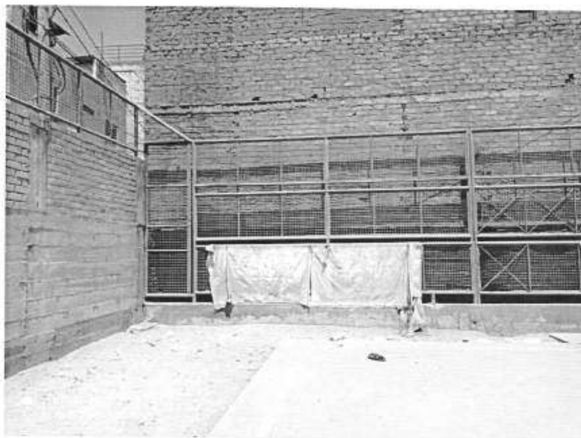
Mallas en mal estado. Piso en mal estado.
