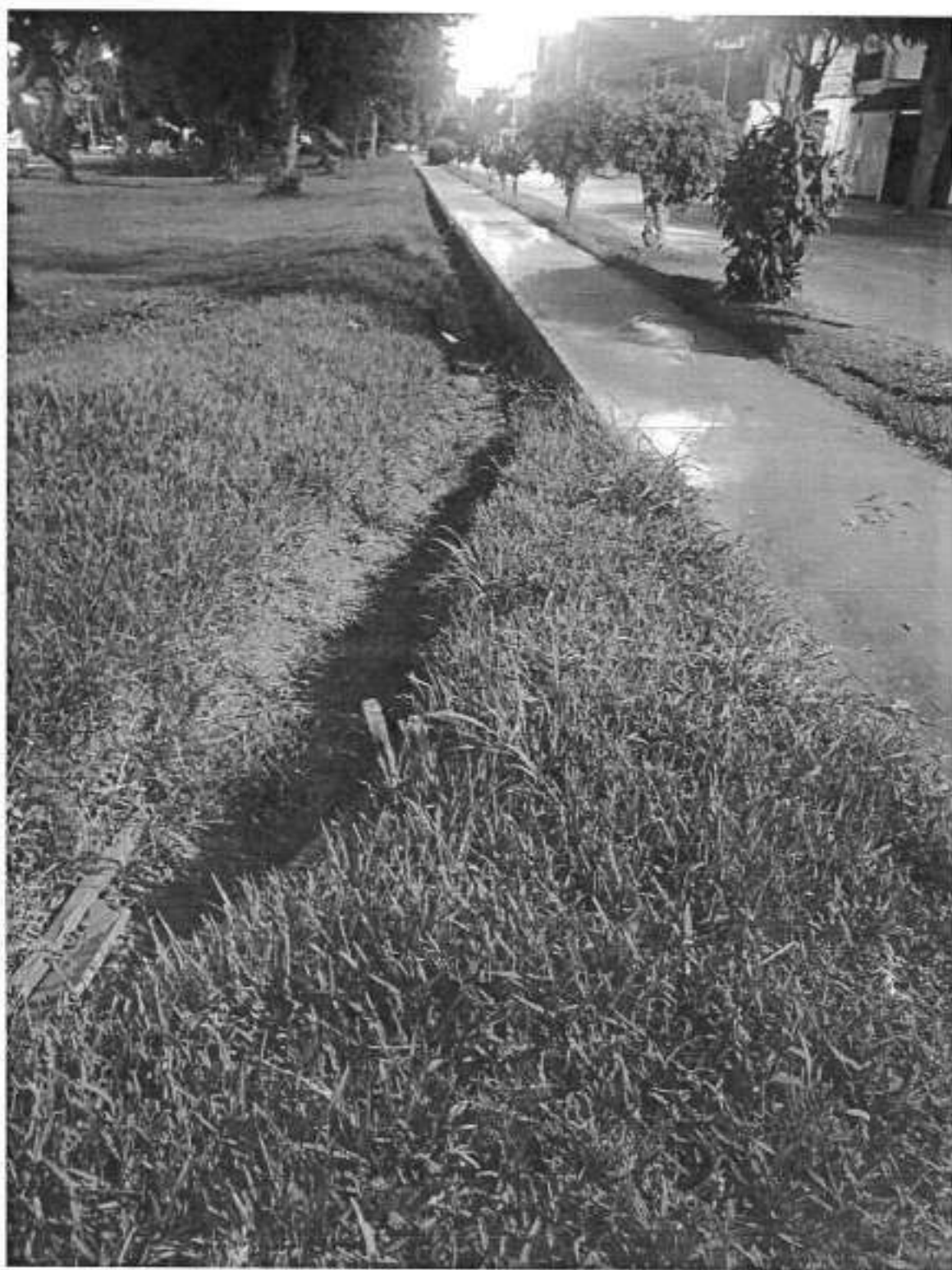
ZONA PELIGROSA HAY UN HUECO ESQUINA DEL PARQUE ENTRE DOÑA CATALINA Y DOÑA LUISA
